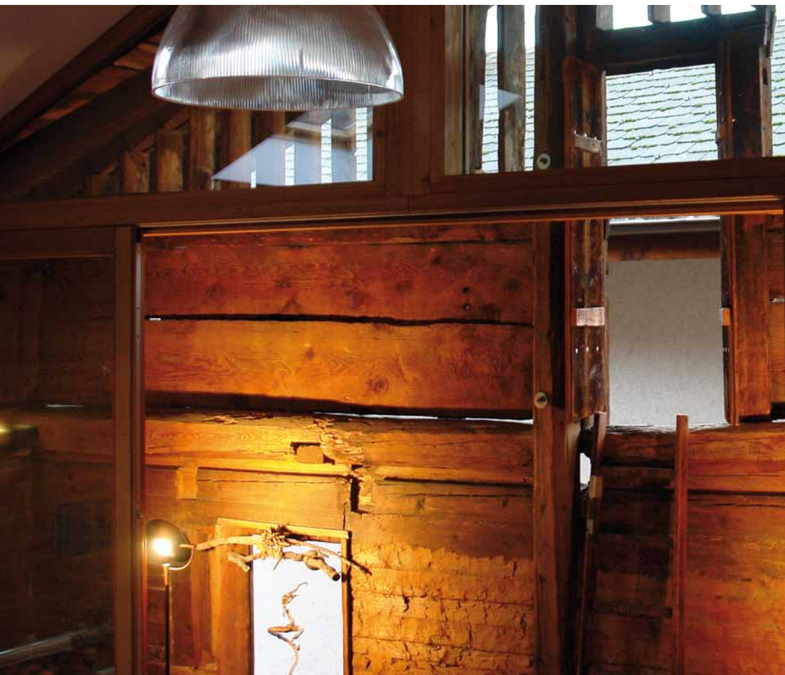
/DÉTAIL DE L'INTÉRIEUR DE LA FAÇADE SUD, L'ATELIER SE TROUVE PROTÉGÉ DERRIÈRE UNE PEAU DE VERRE DONNANT CÔTÉ RUE SUR CE FIN ESPACE DÉAMBULATOIRE QUI PERMET UNE SORTIE DE VISION DE MARIONNETISTE AVEC LES PASSANTS ET LA VIE QUI FILE JUSTE AU DESSOUS DANS LA RUE DU VILLAGE
